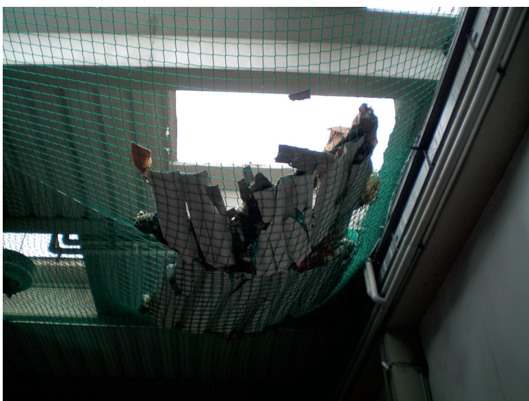
Figura 5.3.2-3 - Esempio di sistema S: caduta di materiali dall'alto
